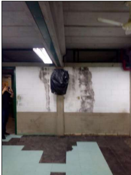
Figura 3 Parede em sala de aula da EEEM Neuza Goulart Brizola CAIC
